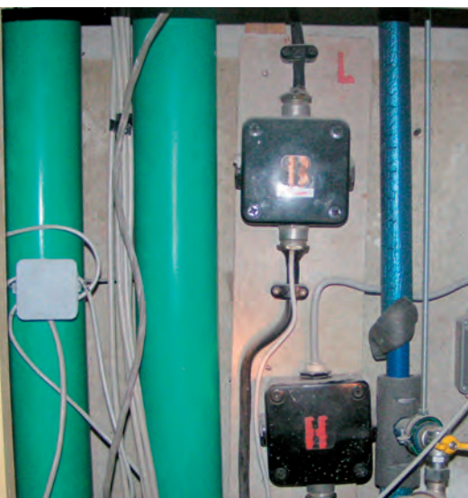
alte Kunststoffrohre im Schacht Friedrich-Hähnel-Straße 11–33
